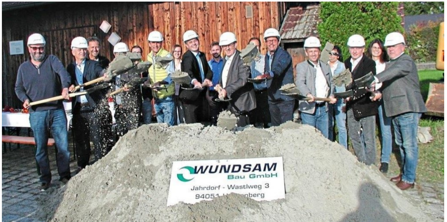
Den Spatenstich für den Breitband- und Wasserleitungsbau Hengersberg Ost (BA1) vollzogen (vorne von links) Marktrat Raimund Nadolny, Franz Hofmann (HPE GmbH), Uli Weidinger (Geoplan), Thomas Ranzinger (Fa. Wundsam), Werkleiter Alexander Eberle, Bürgermeister Christian Mayer, Bernd Strathmeyer (EBB), 2. Bürgermeister Mathias Berger, 3. Bürgermeister Ewald Straßer und Hermann Gruber (Waldwasser). –Foto: Robert Fuchs
